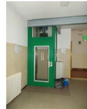
Esempio elevatore interno edificio
